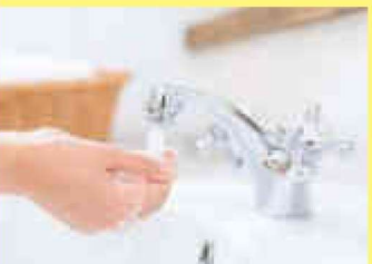
洗面所の排水口のつまり・異臭
